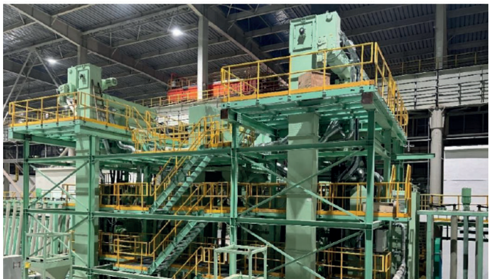
Gigantische Ausmaße: Die Vertikalstrahlanlage ist 14 Meter hoch und steht in einer zweieinhalb Meter tiefen Grube. Vier Inspektionsbühnen inklusive Aufstiegtreppen geben der Anlage ein noch imposanteres Erscheinungsbild.
