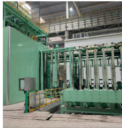
Poco antes de llegar a la granalladora, las chapas de hasta 160 mm de grosor y 4100 mm de altura, se colocan en posición vertical y son transportadas a la granalladora a través de un sistema de transporte de rodillos. Estas atraviesan la granalladora a una velocidad de hasta 7 m/min
